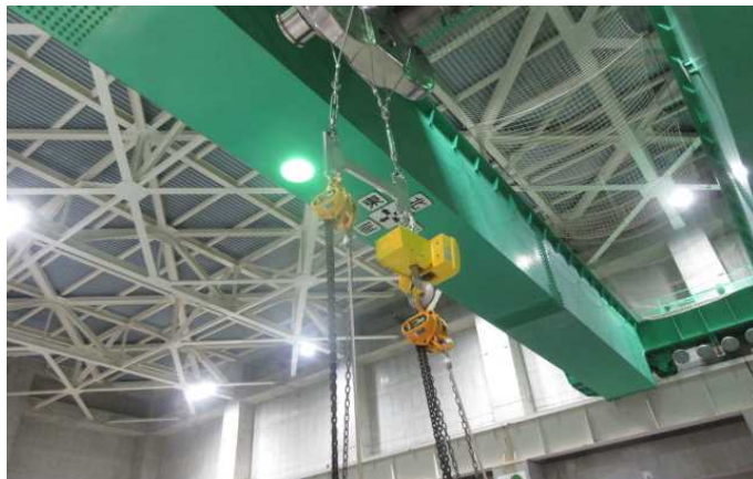
天井クレーン主巻での収納缶吊り具の取り扱い
