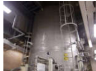
⑤純水貯槽
