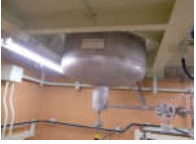
①洗浄液調整槽
