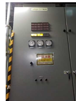
直流125V電源盤
