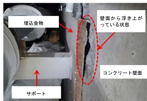
図3 2015年8月26日に確認した埋込金物の状況
