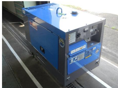
可搬型発電機
