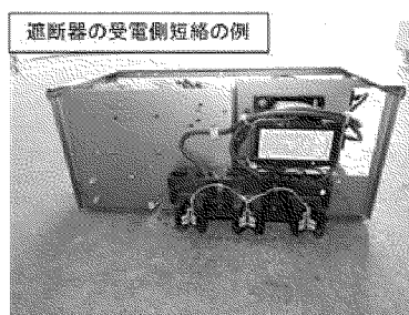
図 4.5.3 遮断器の短絡箇所 (C/C 試験時)
