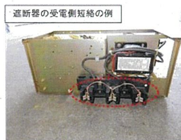
図 4.5.3 遮断器の短絡箇所 (C/C試験時)
