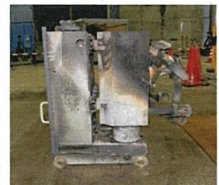
遮断器室アーク発生、アーク火災有、消火後の遮断器の様子
