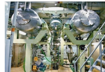
重水ポンプ室
