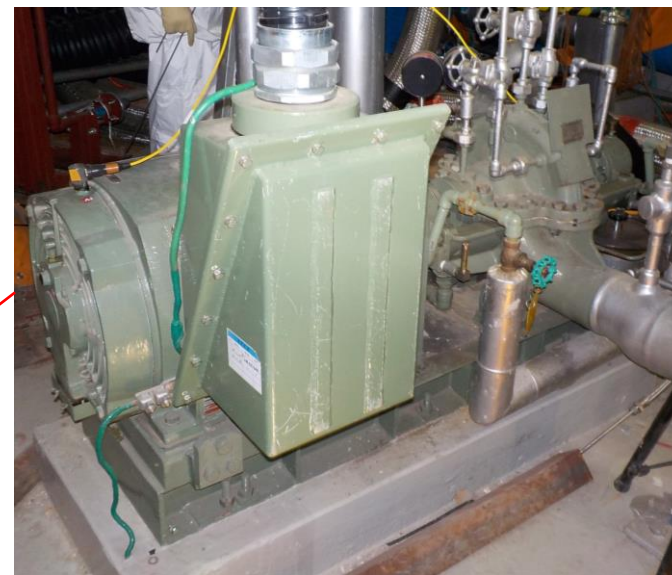
既設FPCポンプの設置状況
