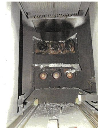
盤内開口部の状態(遮断器室)
