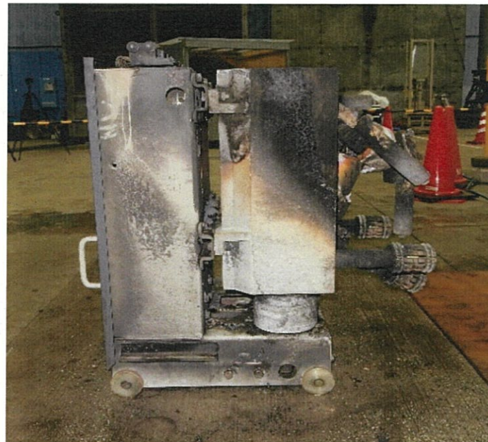
電気盤遮断器室アーク発生、アーク火災有、消火後の遮断器の様子
