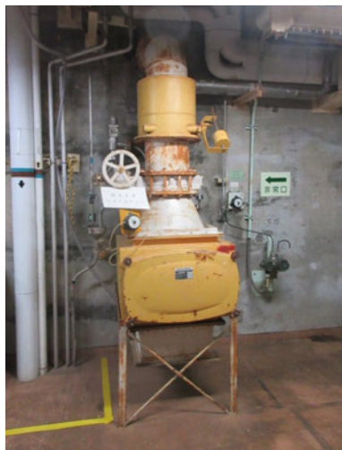
21. R114入気ダクト
