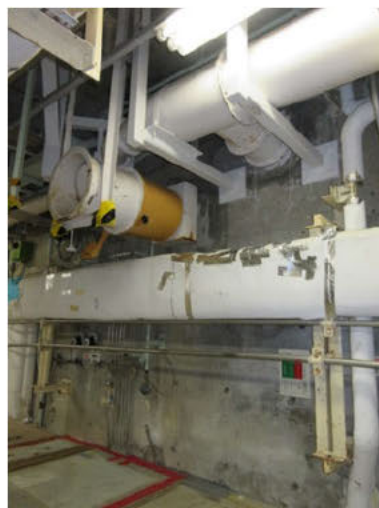
8. R041入排気ダクト
