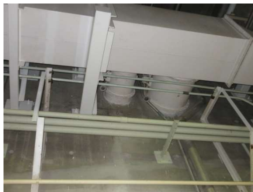
32. R016排気ダクト
