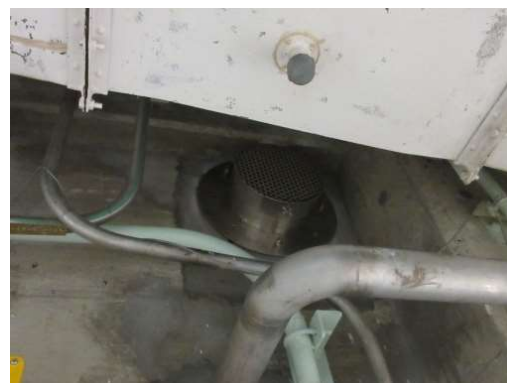
4. R023入気ダクト
