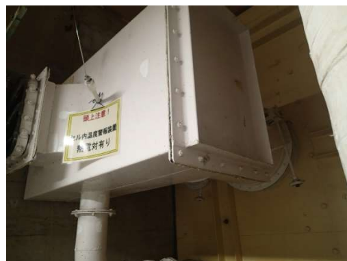
13-2. R026排気ダクト
