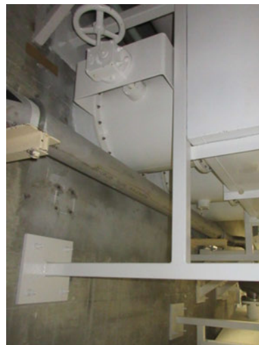
2. R020排気ダクト
