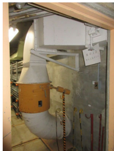
18. R015入気ダクト
