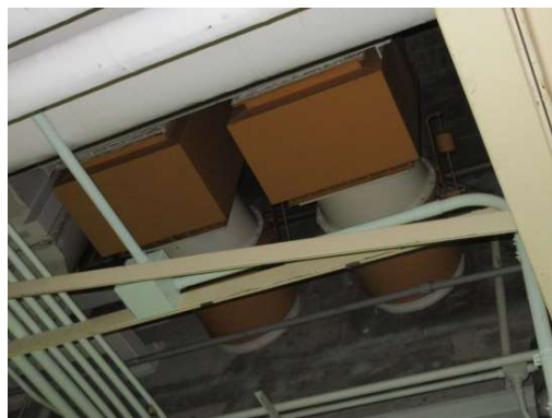
30. R018入気ダクト
