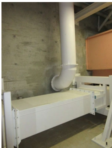
3. R023排気ダクト
