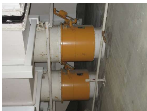
27. R017入気ダクト
