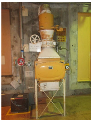
23. R109B入気ダクト
