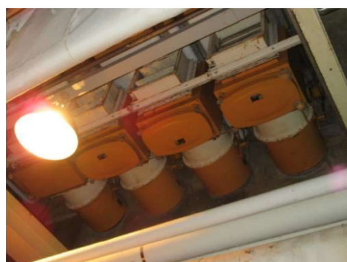
28. R020入気ダクト
