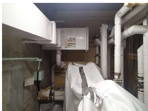
13-1. R026排気ダクト
