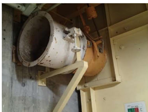
9-1. R026入気ダクト
