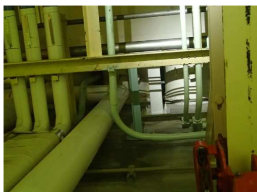
29-1. R006排気ダクト
