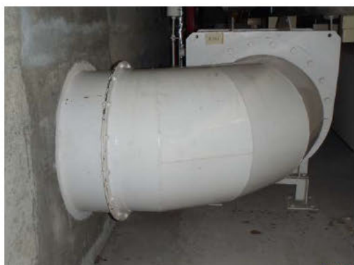
7. R041入気ダクト
