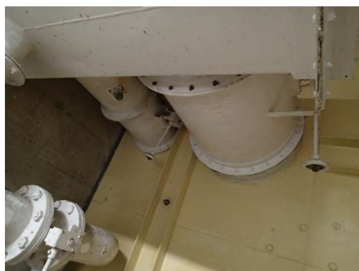
13-3. R026排気ダクト
