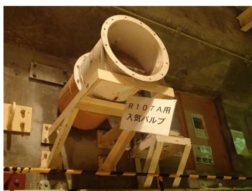
24-2. R107A入気ダクト
