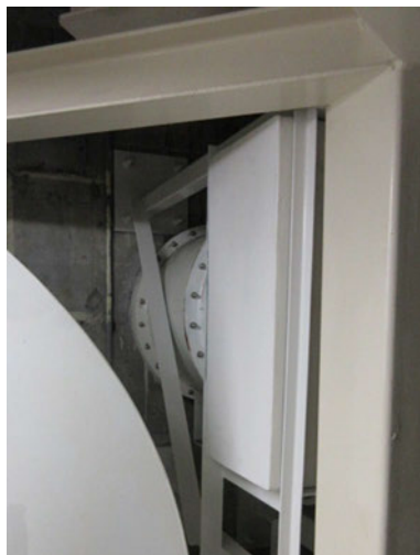
1. R018排気ダクト
