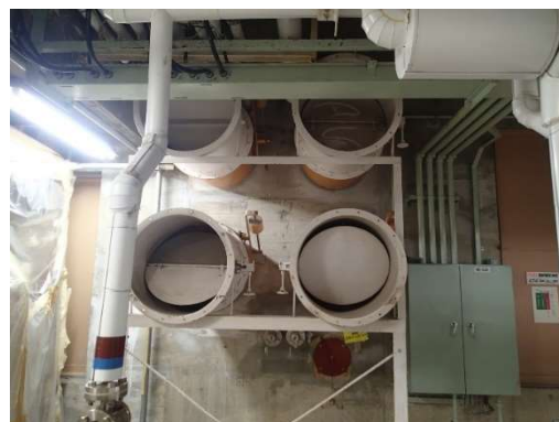
12. R006入気ダクト
