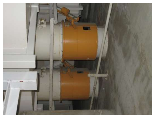
26. R016入気ダクト
