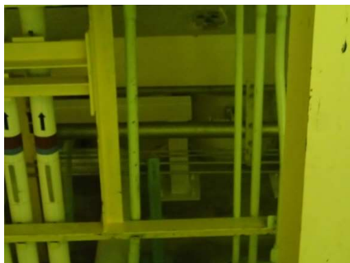
29-3. R006排気ダクト
