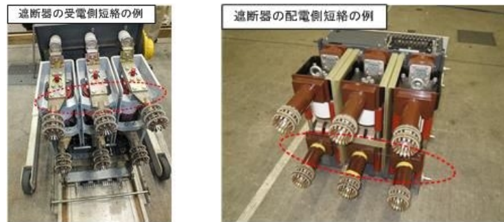
図 4.5.1 遮断器の短絡箇所 (M/C試験時)
