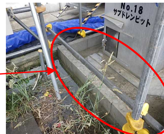
2017年の対策で設置された堰 （サブドレンNo.18ピット周囲）
