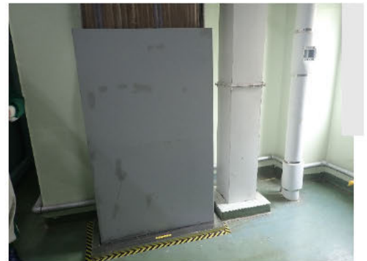
11. ケーブルダクト
