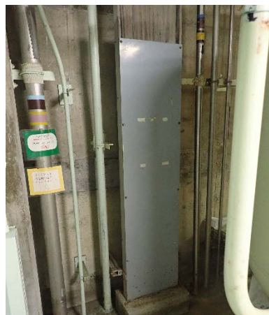
77. ケーブルダクト
