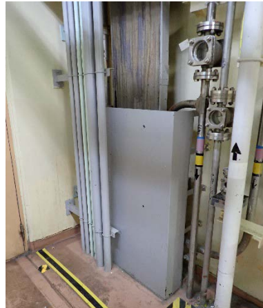
46. ケーブルダクト
