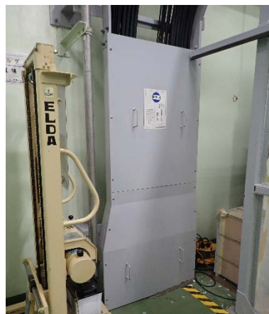
17. ケーブルダクト
