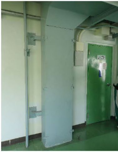
5. ケーブルダクト
