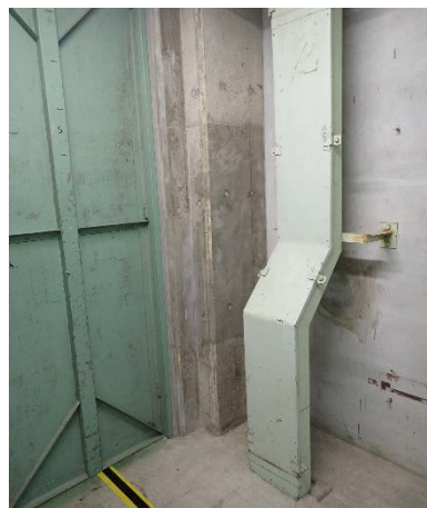
80. ケーブルダクト
