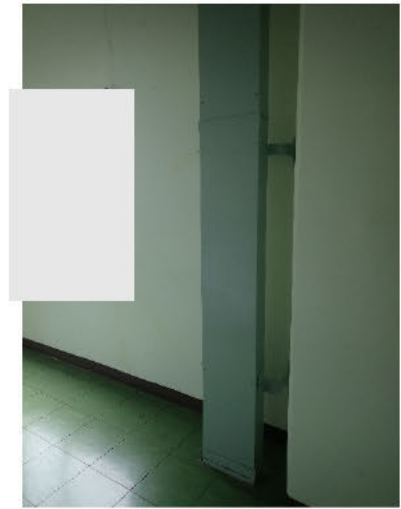
9. ケーブルダクト
