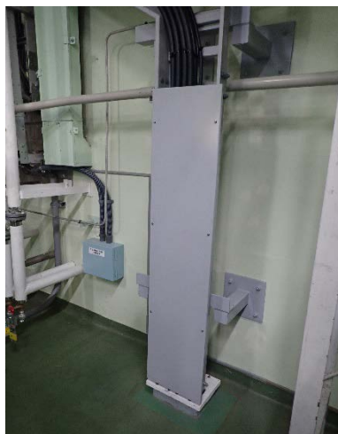
12. ケーブルダクト
