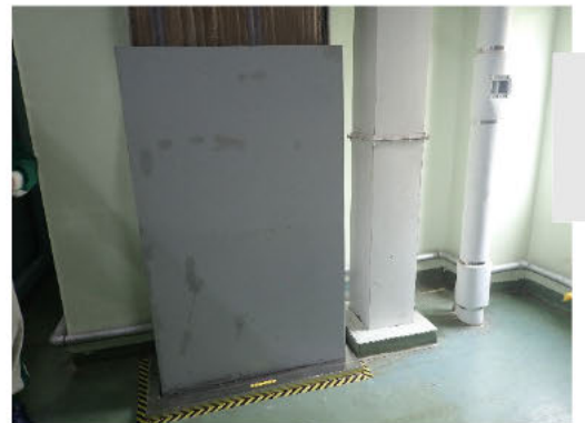
11. ケーブルダクト
