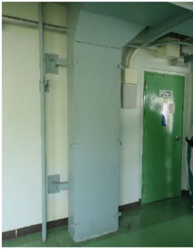
5. ケーブルダクト
