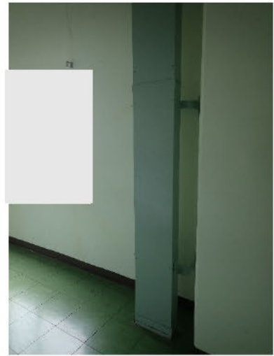
9. ケーブルダクト
