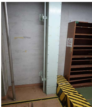
45. ケーブルダクト
