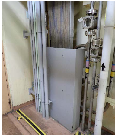
46. ケーブルダクト
