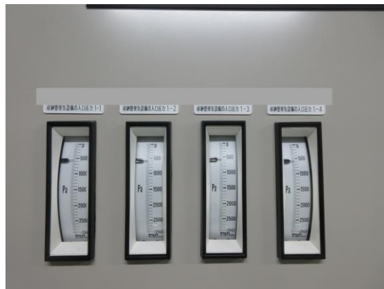
現場監視制御盤
