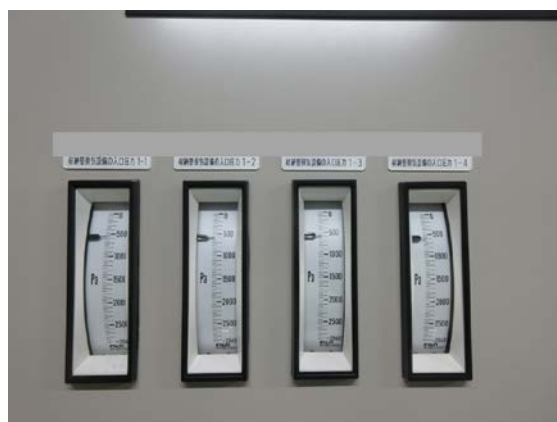
現場監視制御盤
