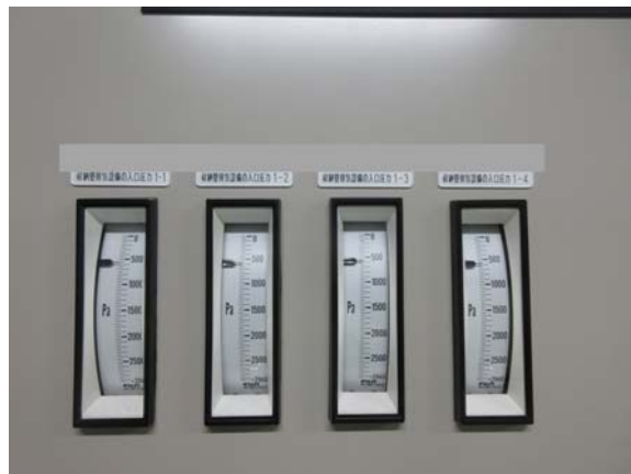
現場監視制御盤
