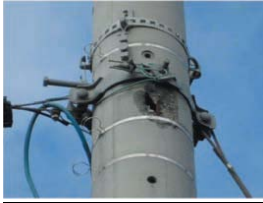
図 4-14-1 コンクリートの剥離事例 (1)
