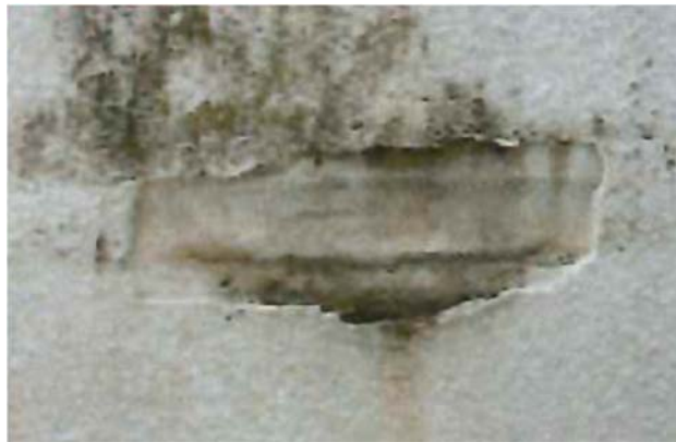
写真 10 表面被覆の剥離(1号 4-C 覆い側部)
