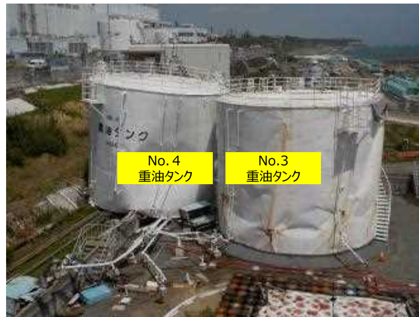
No.3,4重油タンク状況
