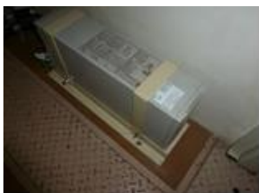
(無停電電源装置の写真)
