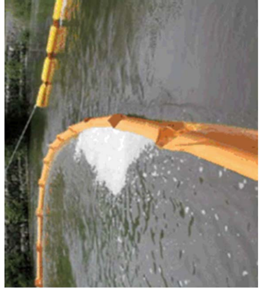
可搬型汚濁水拡散防止フェンス
