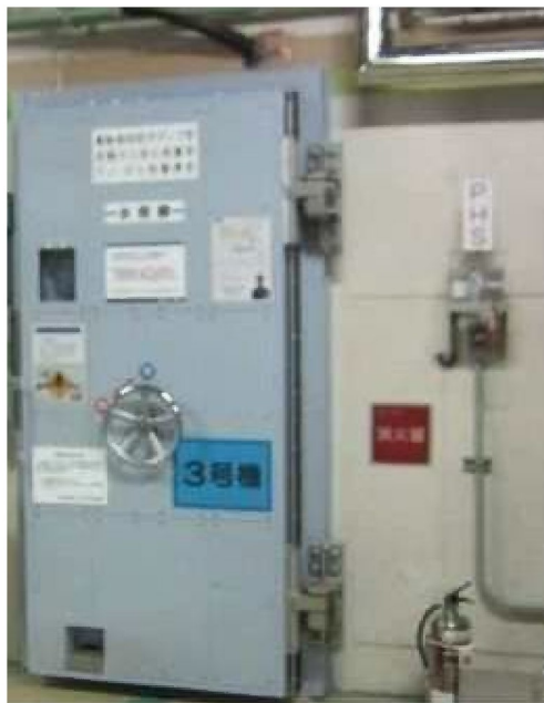
図-2 水密扉等の設置例
