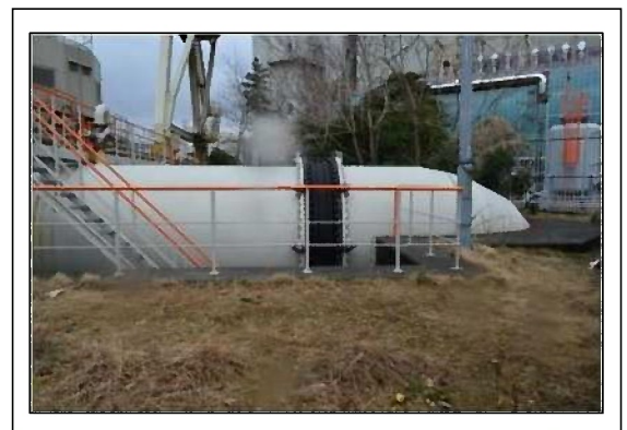
循環水ポンプ出口配管
