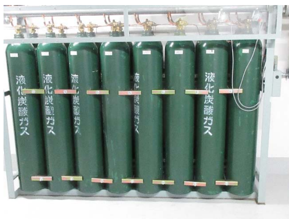
CO 2 ボンベ設置状況
