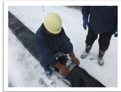
建屋外ホース接続 (300A)
