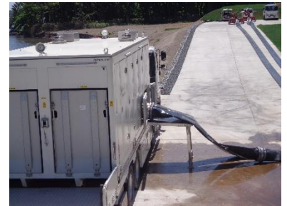
可搬型建屋外ホース接続 (300A)
