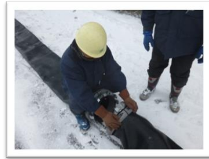
建屋外ホース接続 (300 A)
