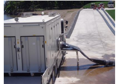
可搬型建屋外ホース接続 (300 A)
