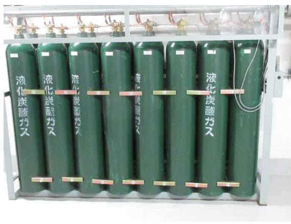
CO 2 ボンベ設置状況
