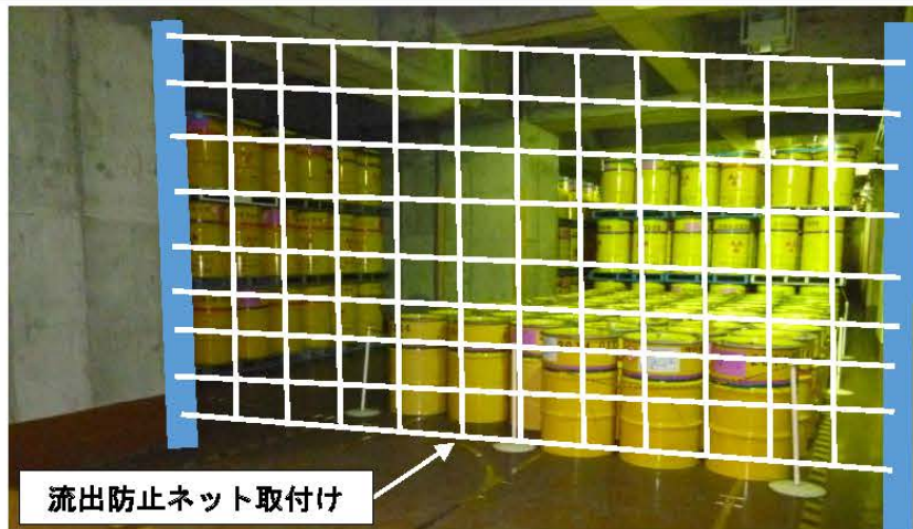
1LASWS 1 階の固縛処置案 (流出防止ネットによる固縛)
