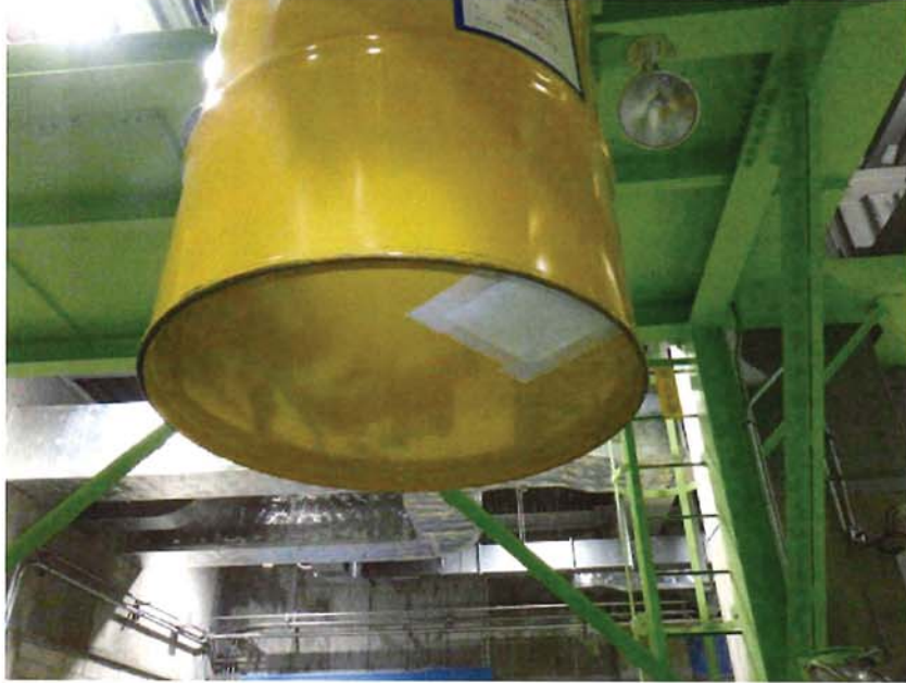
当該廃棄体の錆部への養生状況 (キムタオル及び不燃シートによる養生)
