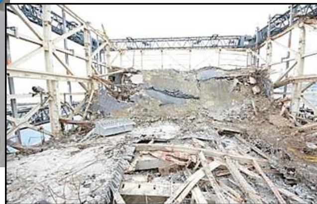
崩落屋根の状況
