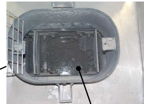
灰搬送コンベア内残水
