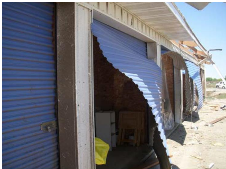
シャッターの外れ
