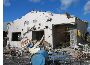
飛来物による被害を受けた建物
