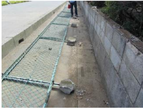
フェンスの倒壊
