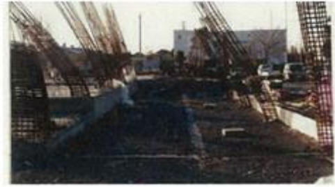
曲がった鉄筋（工事現場）
