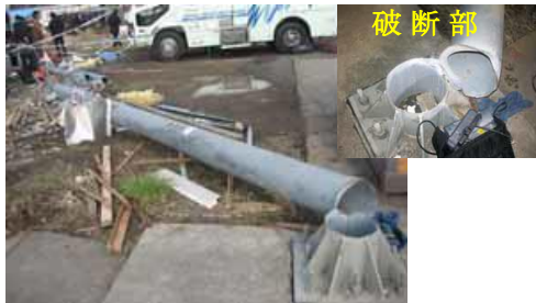
倒壊した道路標識支柱
