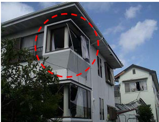
出窓部の窓ガラスの損壊
