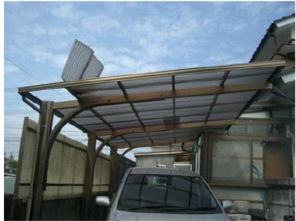
カーポート屋根の損傷
