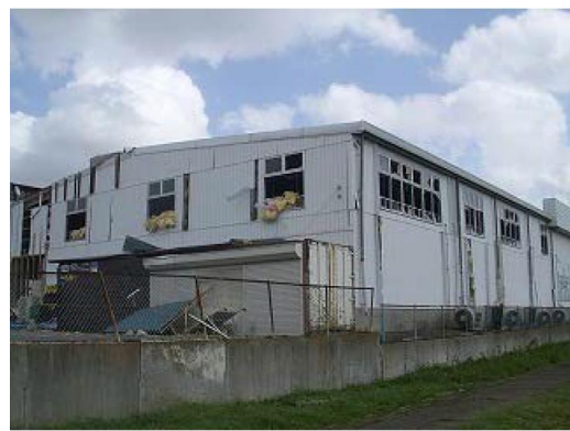
窓ガラスの損壊
