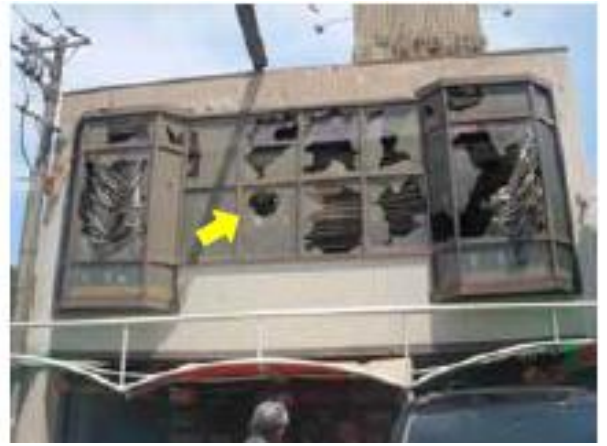
店舗の窓ガラスの被害状況
