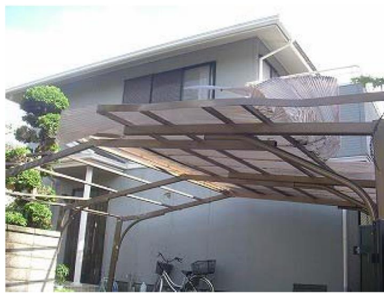
カーポートの被害
