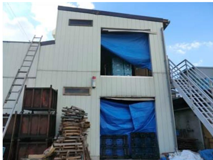
シャッターの外れ
