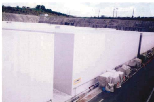
写真4 表面被覆状況(1号4-C)
