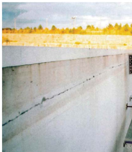
写真1 覆い側部のひび割れ状況
