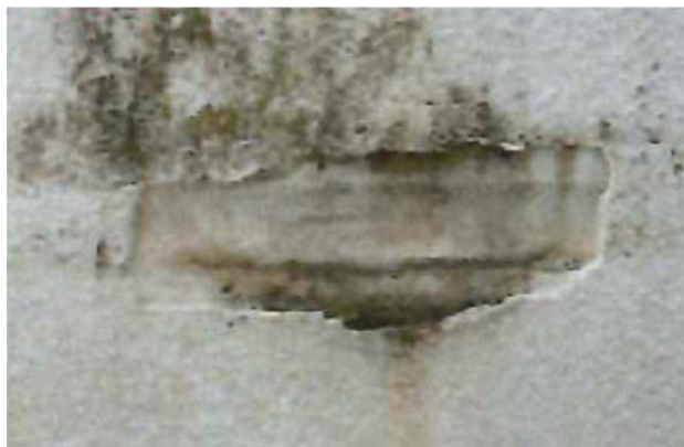
写真10 表面被覆の剥離(1号4-C 覆い側部)
