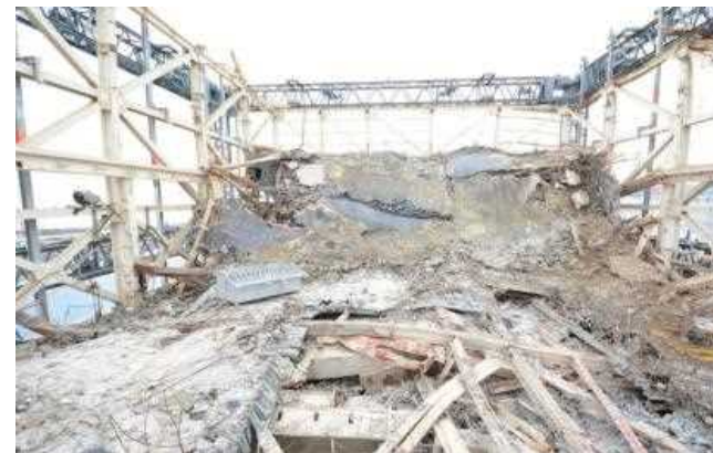
南側崩落屋根の状況
