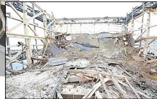
崩落屋根の状況
