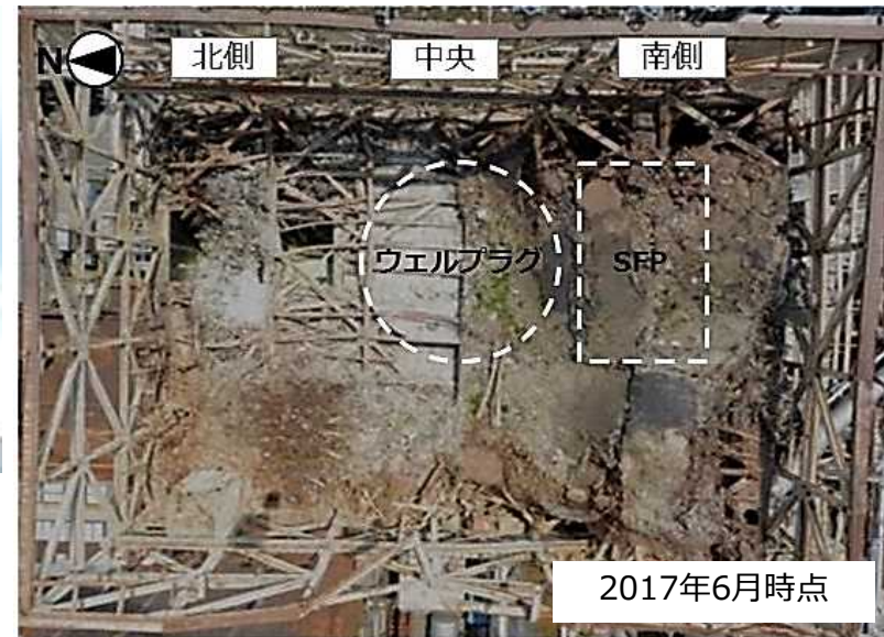
オペフロ上の崩落屋根状況（平面）
