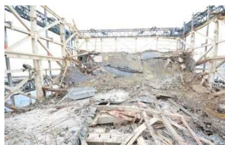
南側崩落屋根の状況
