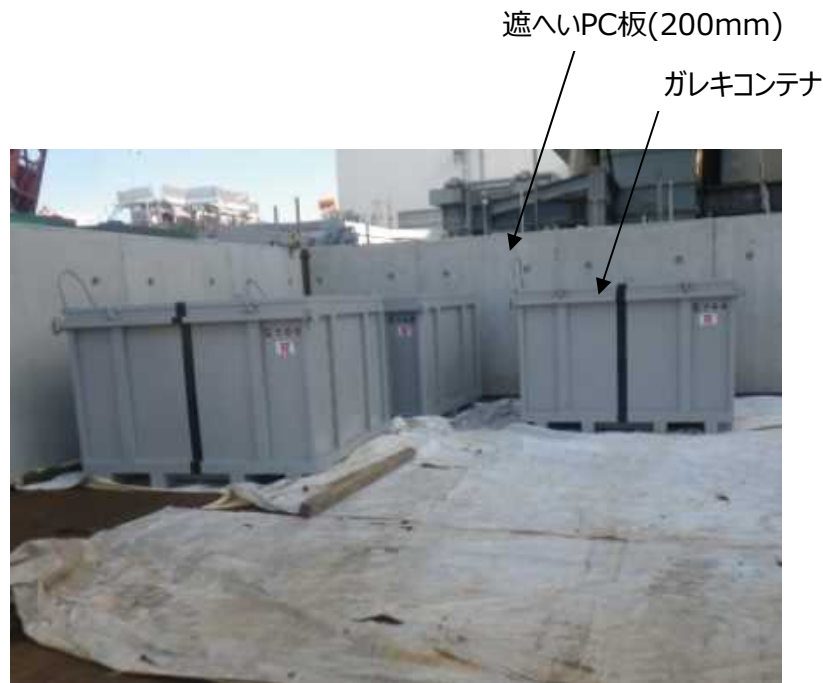
ガレキ置場状況写真
