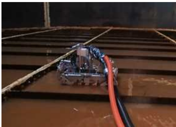
底部残水回収装置 残水回収作業時(実作業)
