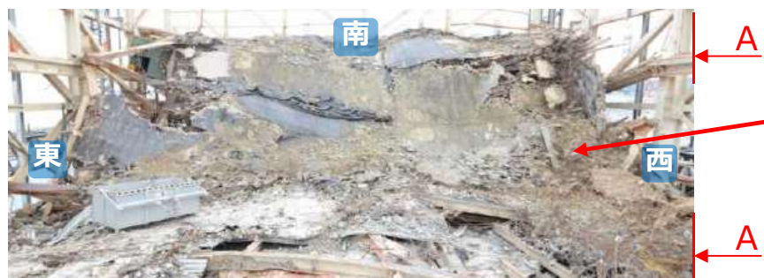
崩落屋根 堆積状態 (南側)
