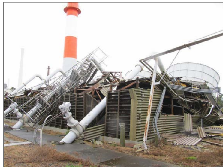
冷却塔倒壊後(R1.9.9撮影)
