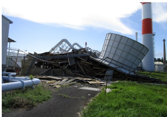
冷却塔倒壊後 北側
