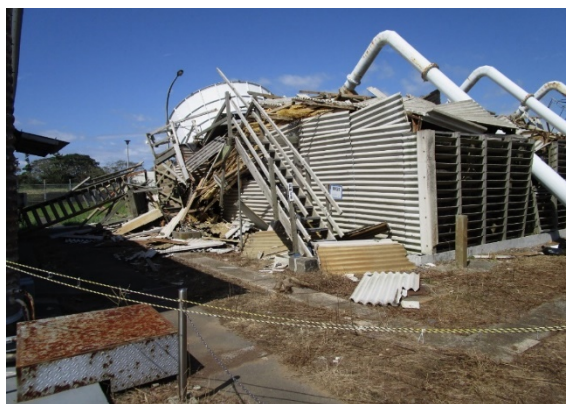
冷却塔倒壊後 南側
