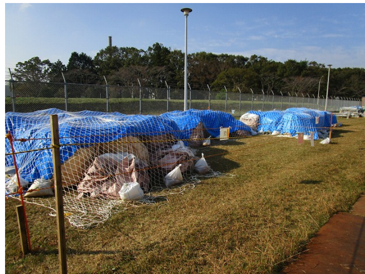
がれき等の仮置き状況(令和元年10月30日撮影)
