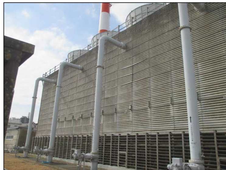
冷却塔倒壊前(H30.2.16撮影)
