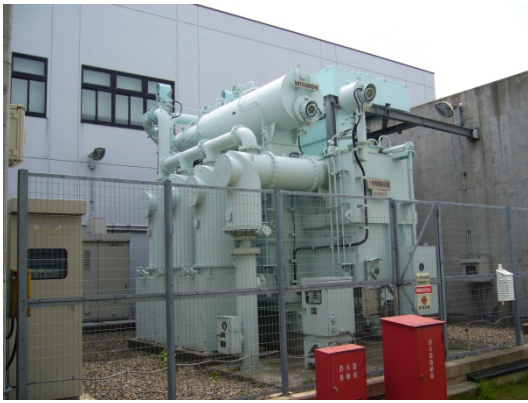
1号受電変圧器
