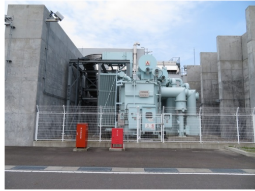
4号受電変圧器
