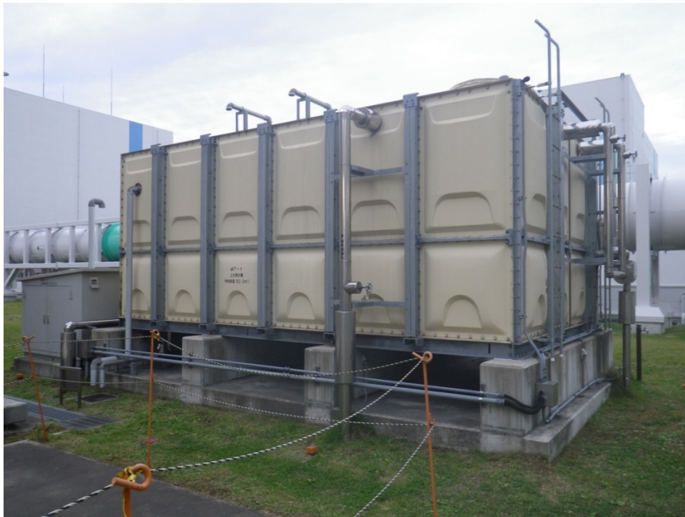
15. H 2 W 新緊急時対策所：受水槽
