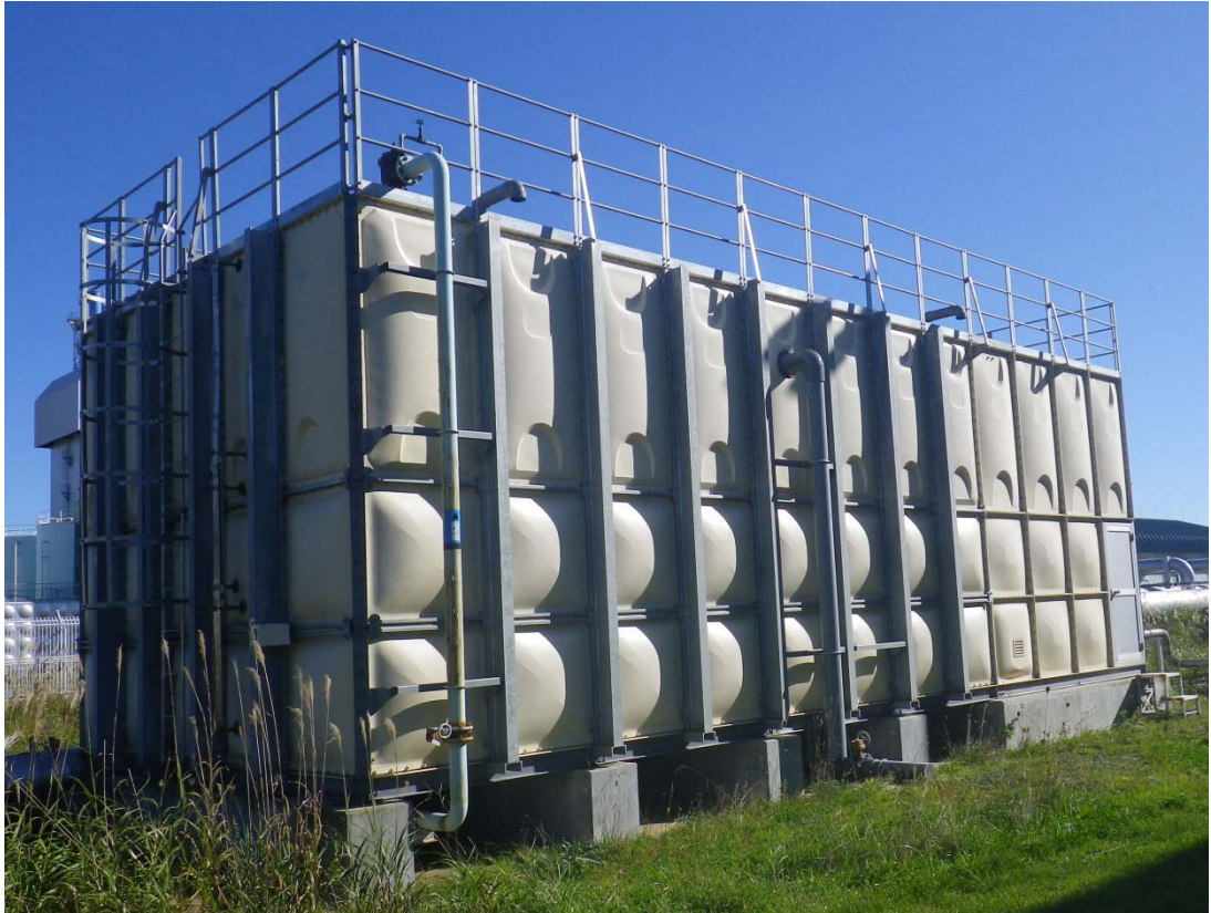
3. G 2 常用冷却水設備：散水用水貯槽 [ ██████████ ]
