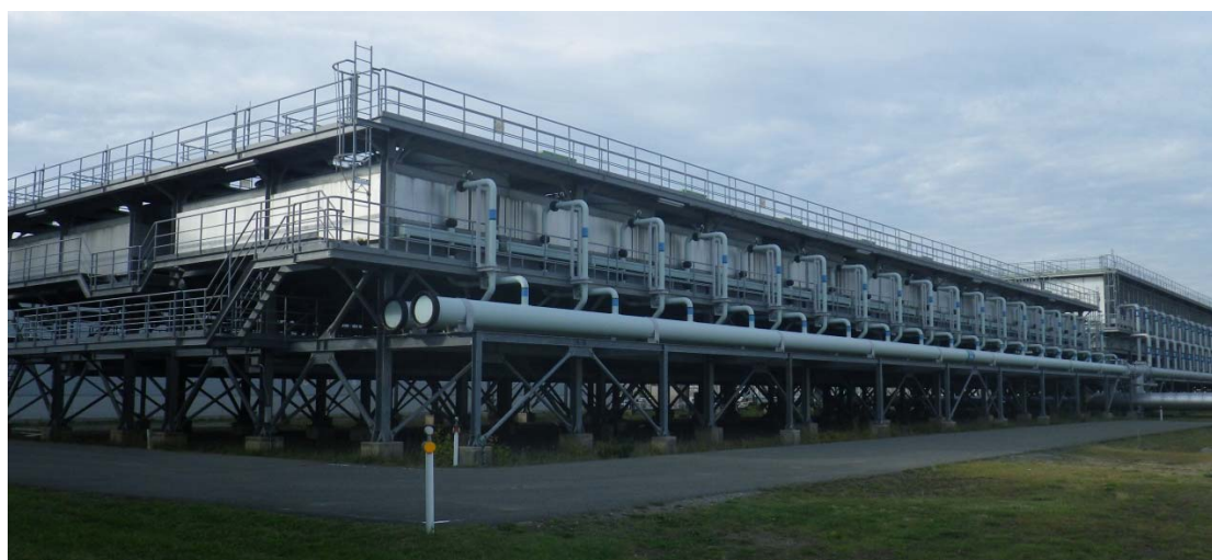
2. G 2 常用冷却水設備：冷却塔 [ ██████████ ]
