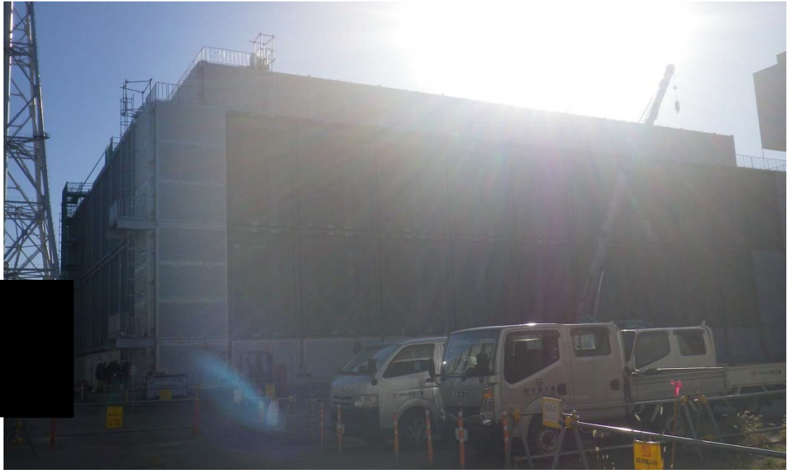
19. 使用済燃料受入れ・貯蔵施設用冷却水設備： 安全冷却水系冷却塔A／膨張槽A [ XXXXXXXXXX ]
