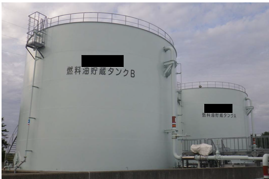
4. G 3 ボイラ用燃料受入れ・貯蔵所： 燃料油貯蔵タンク A / B [ ██████████ ]
