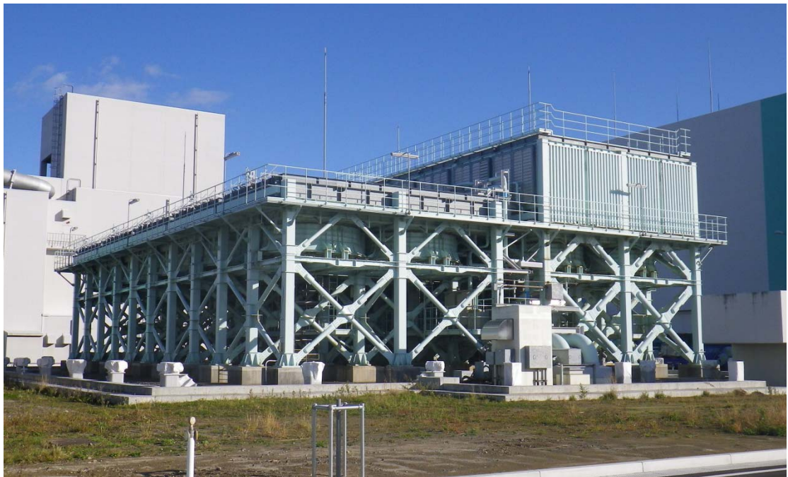
18. 冷却水設備：安全冷却水B冷却塔 [ ██████████ ]
