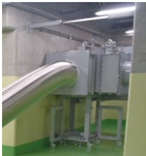
(可搬型設備と常設設備はフランジにより接続)
