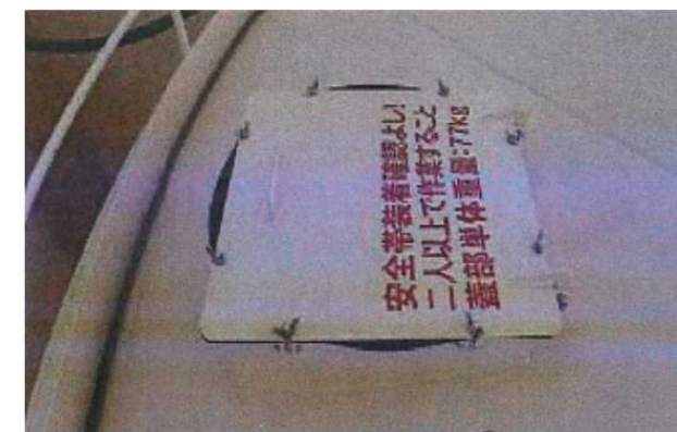
③マンホールパッキンはみ出し
