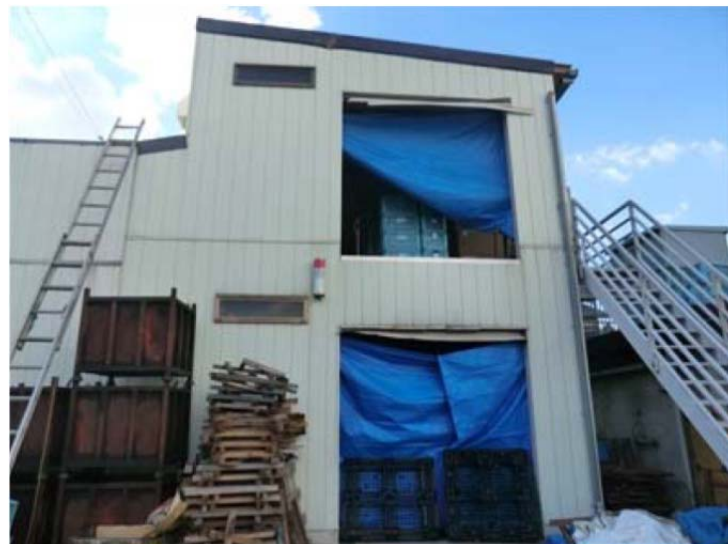
シャッターの外れ
