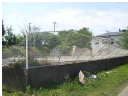
フェンスの変形
