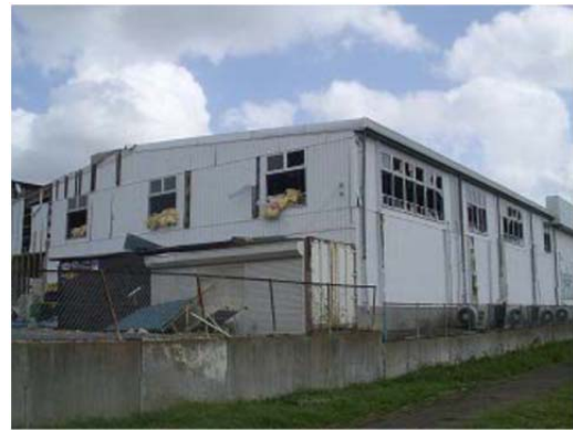
窓ガラスの損壊
