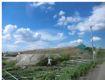
フェンスの倒壊
