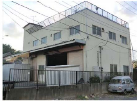
屋上フェンスの変形
