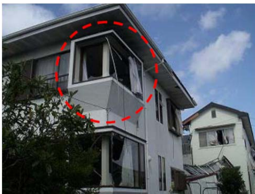
出窓部の窓ガラスの損壊
