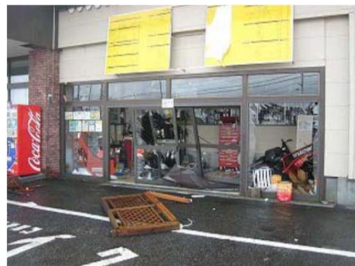
エントランスのガラス損壊
