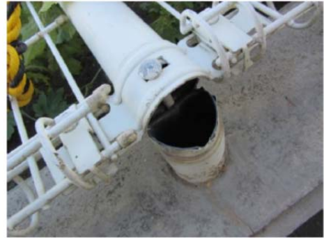
フェンス支柱部の破損
