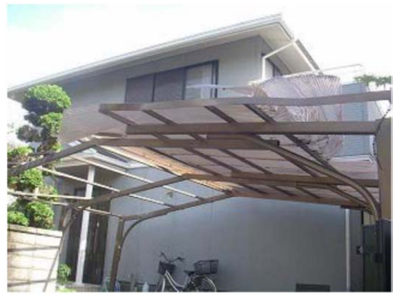
カーポートの被害
