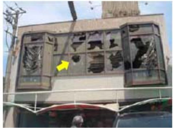
店舗の窓ガラスの被害状況
