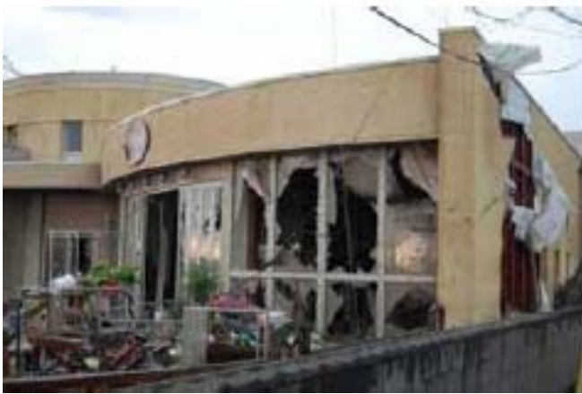
店舗の窓ガラスの被害状況
