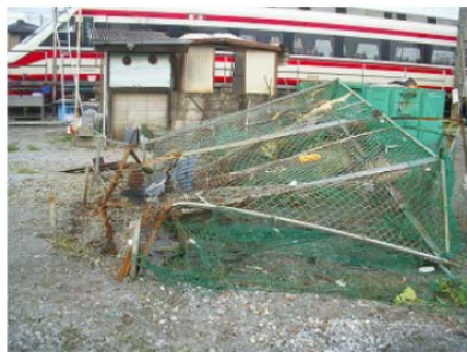
フェンスの著しい変形
