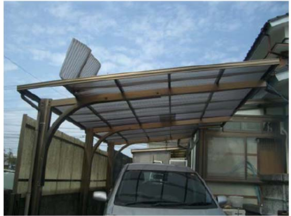
カーポート屋根の損傷
