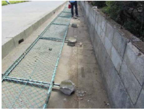
フェンスの倒壊
