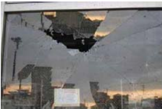
ガラスの被害状況（飛来物衝突痕）
