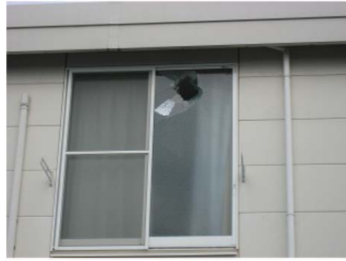
窓ガラスの飛来物衝突痕
