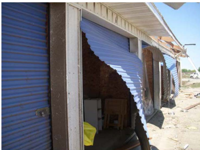
シャッターの外れ
