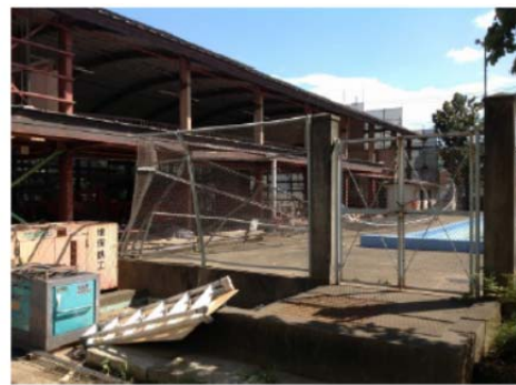
フェンスの変形（工事中の建築物）
