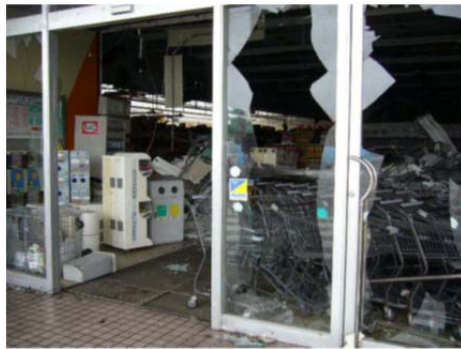
エントランスの窓ガラスの破損
