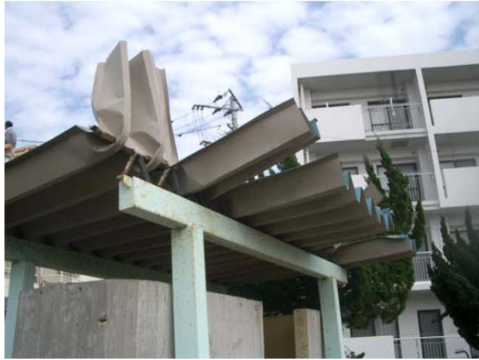
屋外トイレ屋根の損傷
