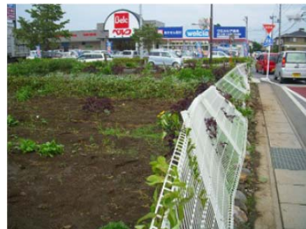
フェンスの変形
