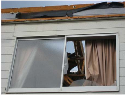
窓ガラスの損壊
