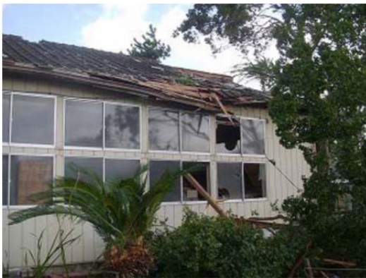
倉庫の窓ガラスと屋根の被害状況
