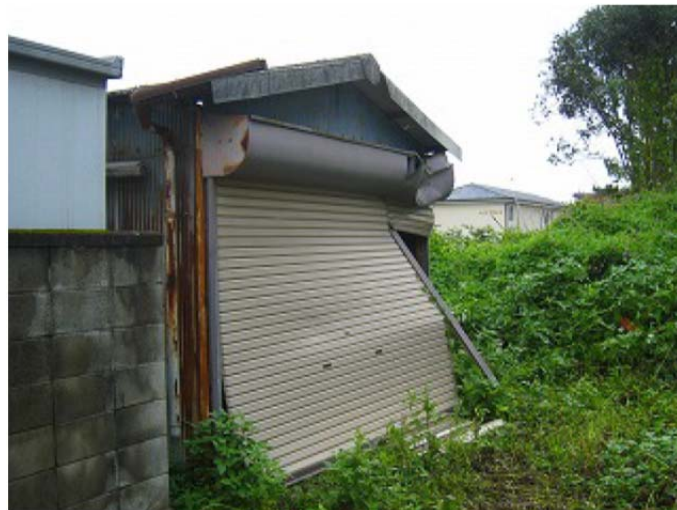
シャッターの外れ
