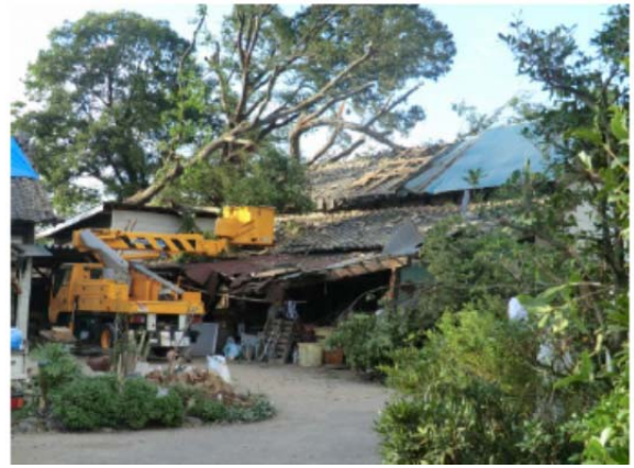
樹木の倒壊による小屋組の被害
