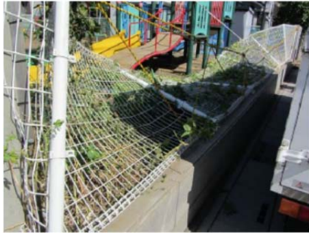
フェンスの変形
