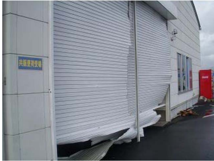
シャッターの変形
