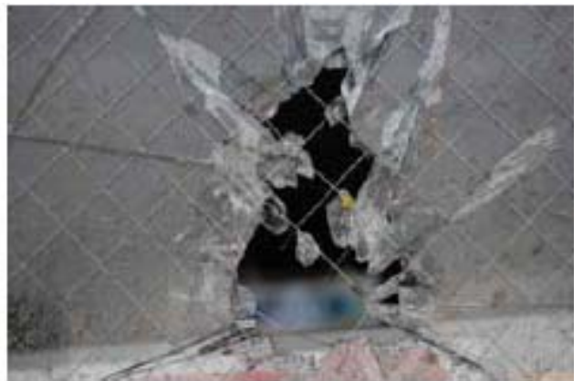
ガラスの被害状況（飛来物衝突痕）
