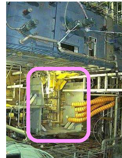
既設ポンプエリア (ホットスポット)
