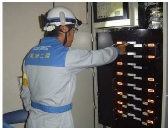
②不要直流負荷切り離し操作 （継電器室）
