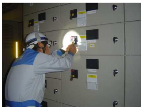
①不要直流負荷切り離し操作 （計装電源盤室）
