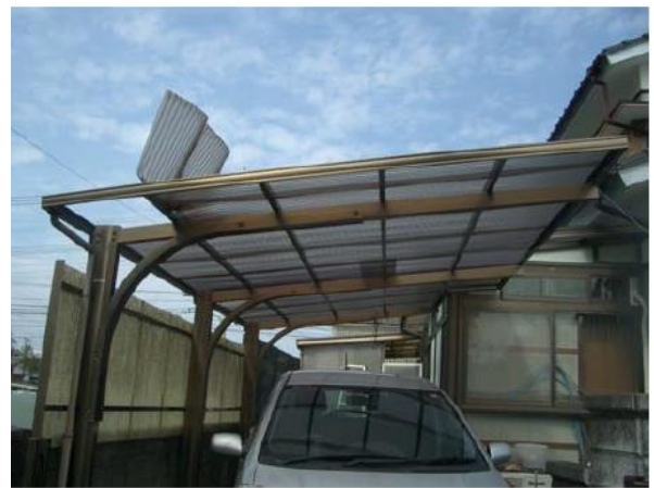
カーポート屋根の損傷
