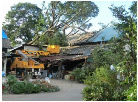
樹木の倒壊による小屋組の被害
