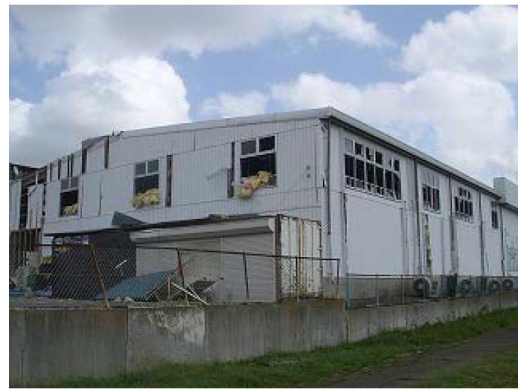
窓ガラスの損壊
