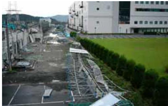
第 29 図 平成 18 年 9 月 17 日宮崎県延岡市で発生した F 2 竜巻による仮設足場の被害状況 (11)
