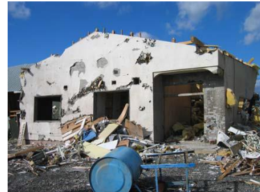
飛来物による被害を受けた建物
