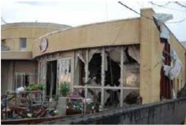
店舗の窓ガラスの被害状況
