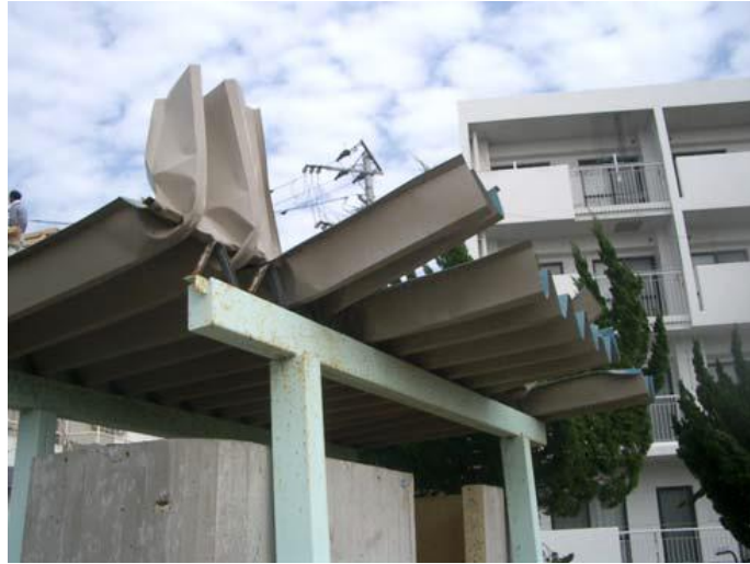
屋外トイレ屋根の損傷
