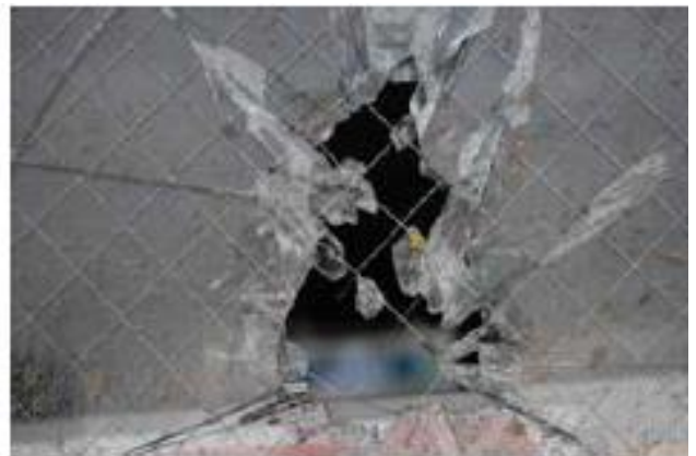
ガラスの被害状況（飛来物衝突痕）
