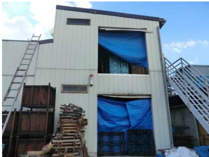
シャッターの外れ
