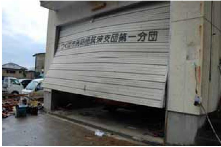
消防団施設のシャッターの変形
