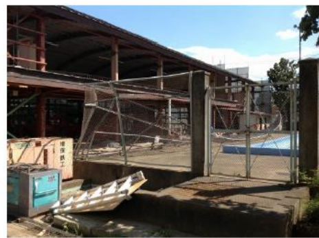
フェンスの変形（工事中の建築物）
