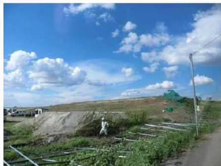
フェンスの倒壊
