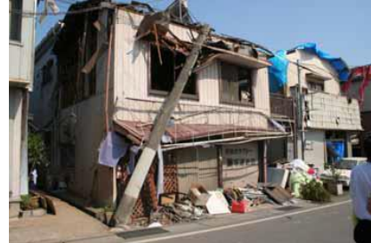
倒壊電柱に直撃された家屋
