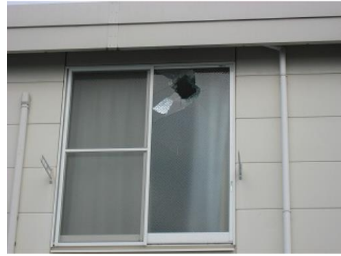
窓ガラスの飛来物衝突痕
